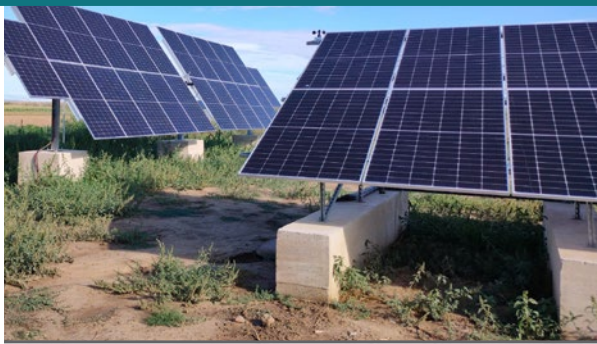
Estructura fija y seguidor.
