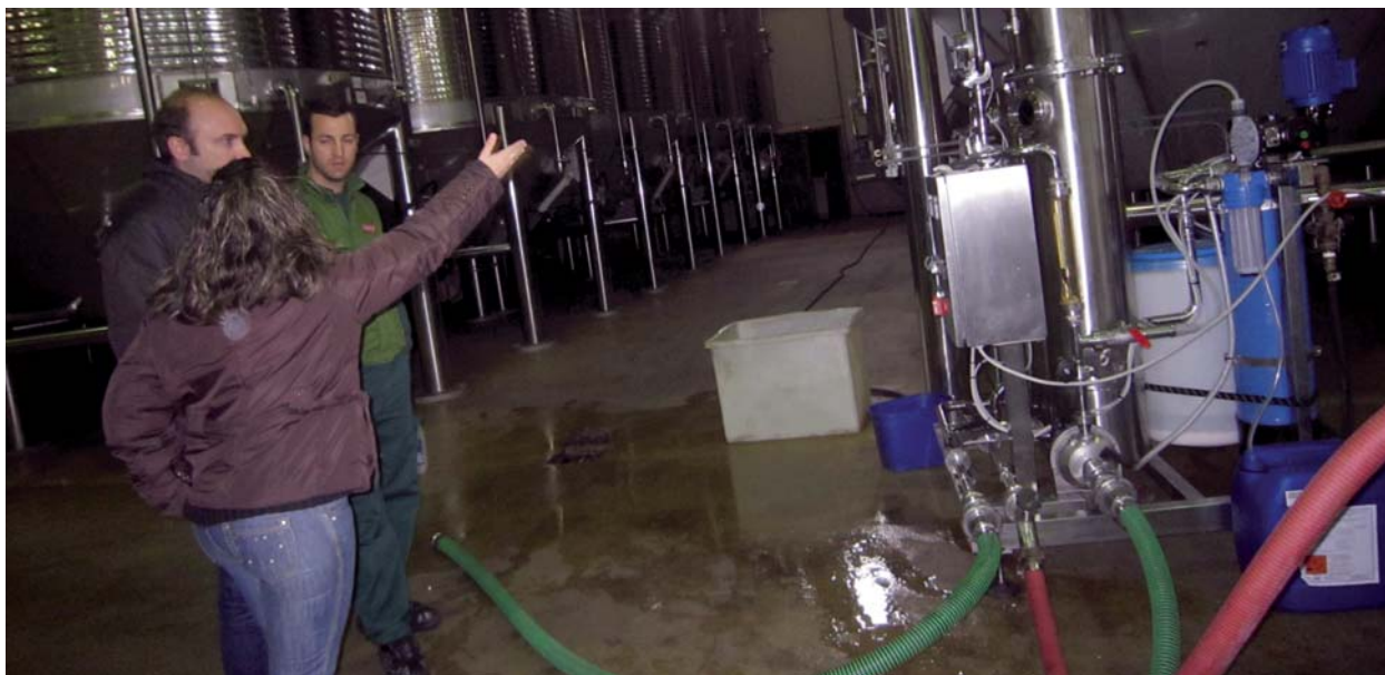
Línea de proceso RIC en Bodega Coop. San Martín (D.O. Navarra)
