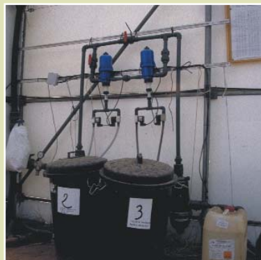
Un sencillo cabezal de fertirrigación como el que aparece en la imagen es suficiente para realizar esta técnica.
