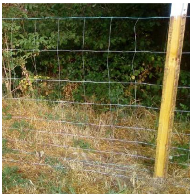
Vallados no enterrados y sin zócalo precisan un control frecuente
