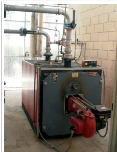
Caldera de calefacción de agua caliente (Navarra)
