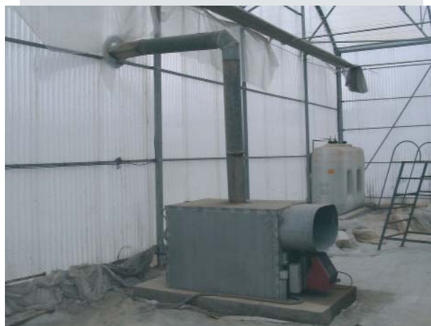
CALEFACTOR POR AIRE CALIENTE., CON SALIDA DE GASES NOCIVOS AL EXTERIOR DEL INVERNADERO. DEPÓSITO DE GASOIL AL FONDO. Finca de Sartaguda.
