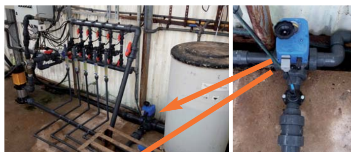
Figura 2. Válvula de recirculación y su ubicación
