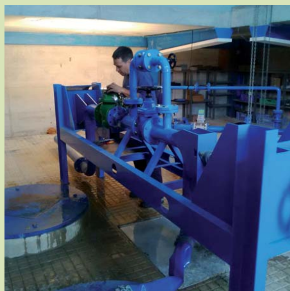
Foto del banco de pruebas de hidrantes en la reconvertida estación de bombeo de Murillo el Fruto
