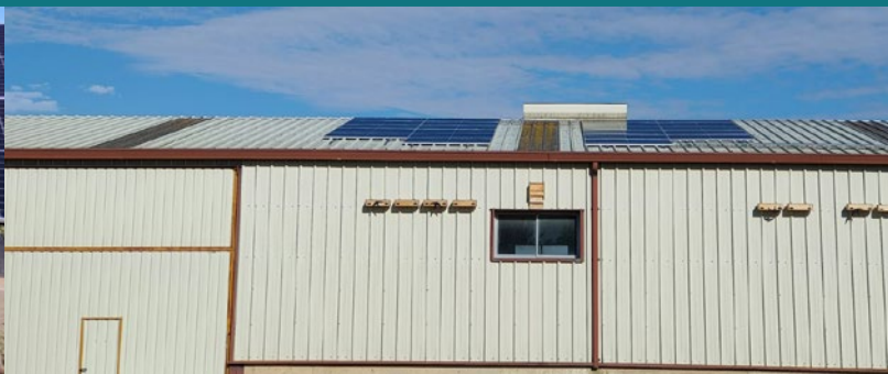
Instalación sobre cubierta.
