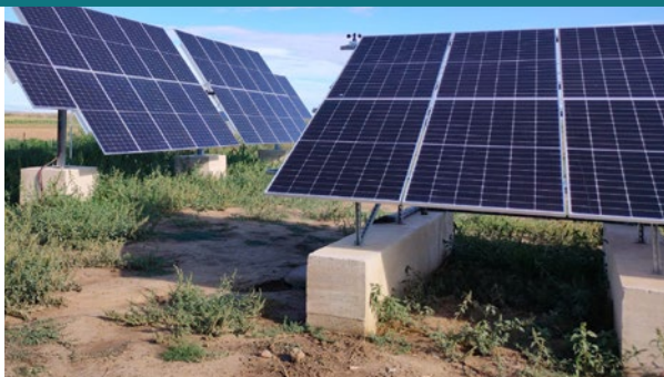
Estructura fija y seguidor.
